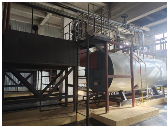
南部工业场地燃气锅炉
