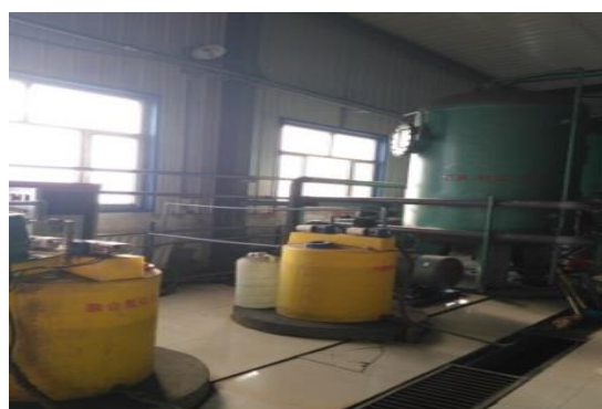
石英砂过滤罐和次氯酸钠消毒
