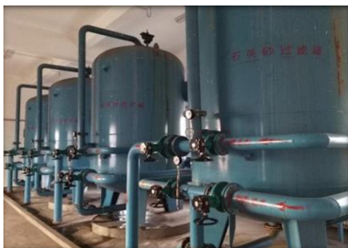
活性炭过滤罐
