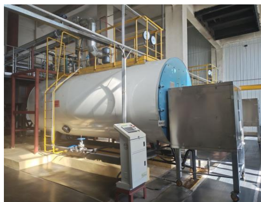
西部工业场地燃气锅炉
