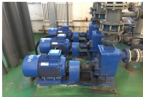
水泵 减振基础
