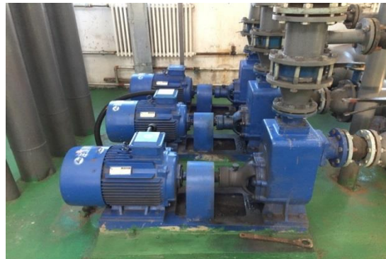
水泵减振基础
