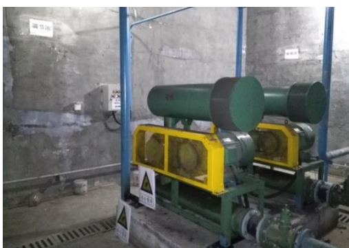
调节池和缺氧池
