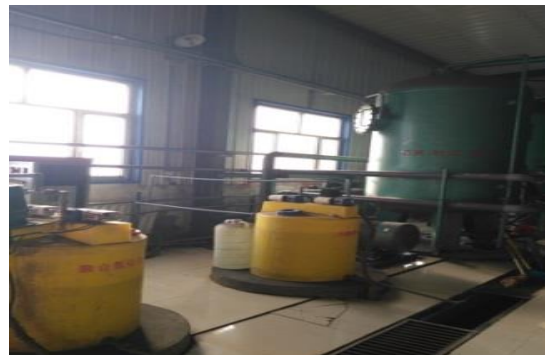
石英砂过滤罐和次氯酸钠消毒
