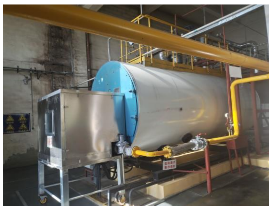
东部工业场地燃气锅炉
